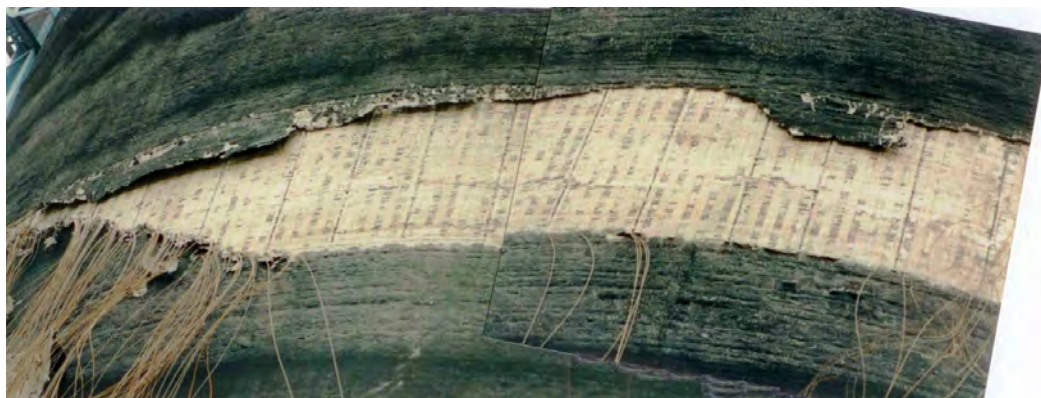
Rys. 5. Widok awarii strun sprężających płaszcz silosu A od strony północno-wschodniej
