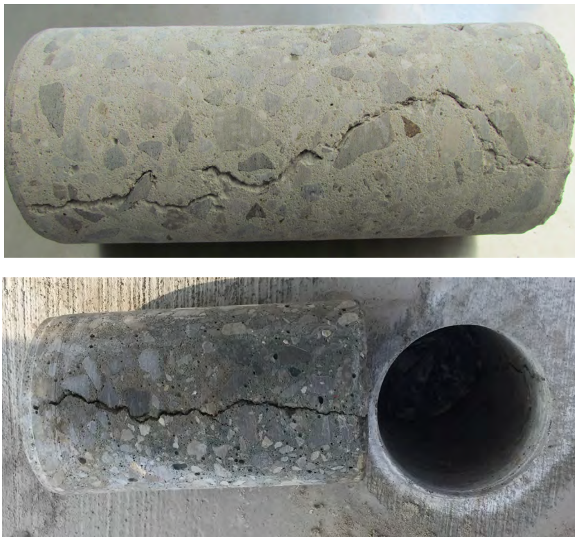
Rys. 2. Fotografia odwierconej próbki ze spękaną płytą betonową
