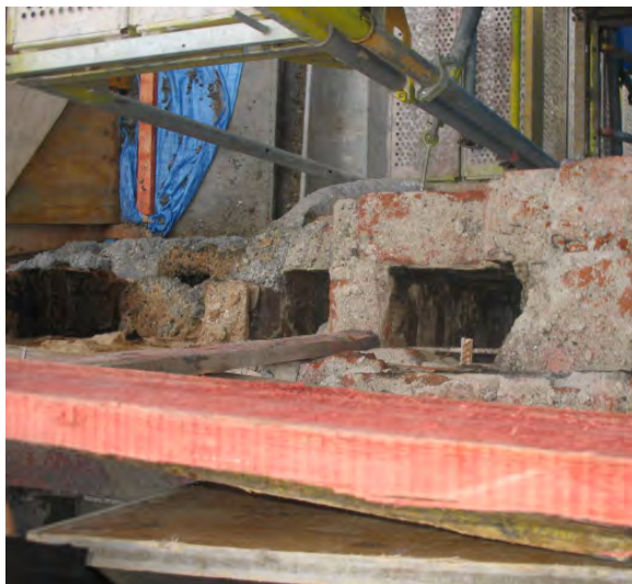
Rys. 5. Niewypełnione przewody kominowe w rejonie osi oB
