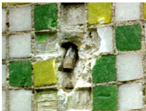
Rys. 1. Widok pękniętego wieszaka w warstwie fakturowej (fot. M. Wójtowicz)
