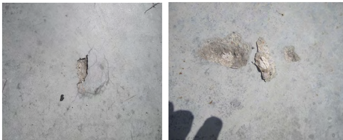
Rys. 5. Punktowy przykład fizycznego charakteru uszkodzeń
