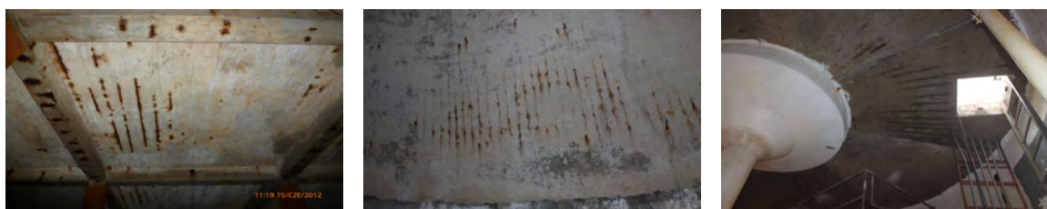
Rys. 4. Korozja prętów zbrojenia w przykryciach zbiorników na wodę (strop płytowo-żebrowy, kopuła, płyta kołista) wynikająca ze zbyt cienkiej otuliny zbrojenia w warunkach wysokiej wilgotności.
