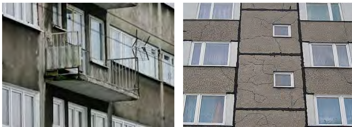
Rys. 3. Degradacja i uszkodzenia elementów zewnętrznych budynków wielkopłytowych
