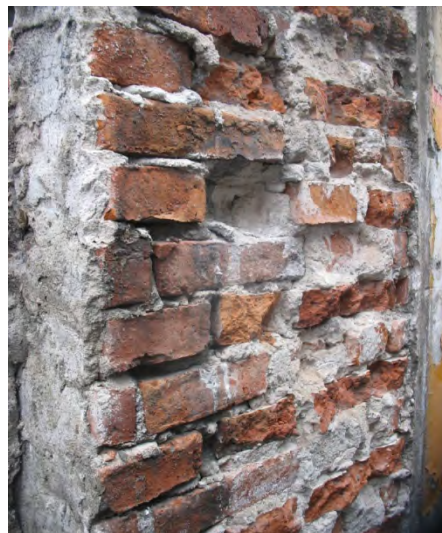
Rys. 6. Fragment pozostałej części ściany
