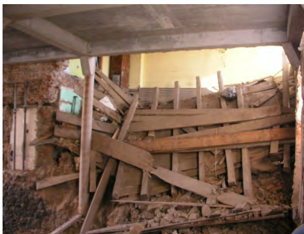
Rys. 11. II faza katastrofy budowlanej
