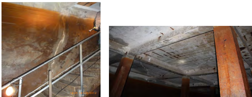
Rys. 2. Zarysowania ścian i stropu zbiornika posadowionego częściowo bezpośrednio, częściowo na palach
