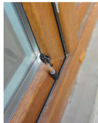
Fot. 2. a) Wadliwe zgrzewy naroży ramy, b) Nieprawidłowo dobrana długość uszczelki, c) Szczeliny w przylgach
