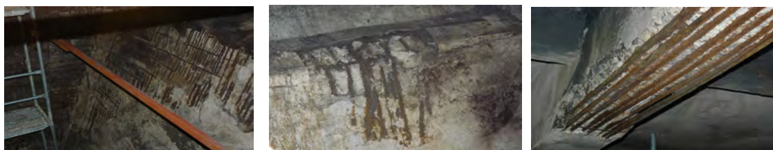
Rys. 6. Degradacja ścian wewnętrznych i belki stężącej w bunkrze na węgiel, w wyniku ścierania i uderzeń brył (fot. R.Compa)
