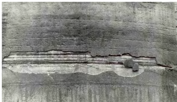
Rys. 3. Silos A po drugiej awarii strun sprężających (kwiecień 1992 r.)
