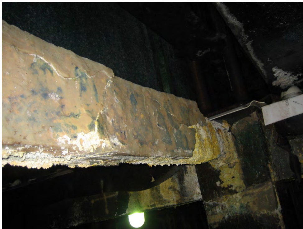
Rys. 6. Widok zniszczonej części belki ryglowej po odsłonięciu powłoki izolacyjnej
