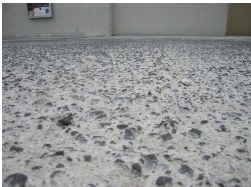
Rys. 4. Postać uszkodzeń mrozowych betonu płyty
