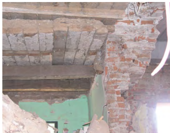
Rys. 10. Wady w strukturze muru w ścianie; ślad ścięcia ściany nad wykutą bruzdą
