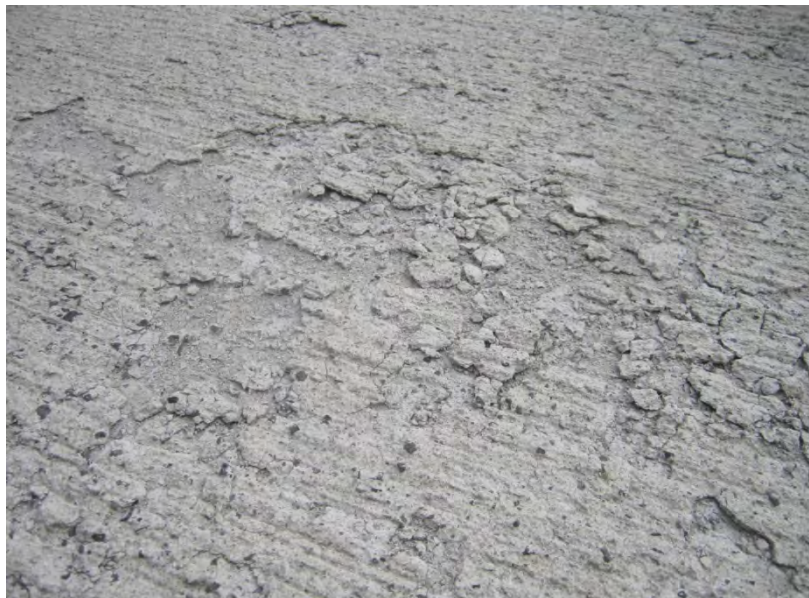
Rys. 3. Postać uszkodzeń mrozowych betonu płyty
