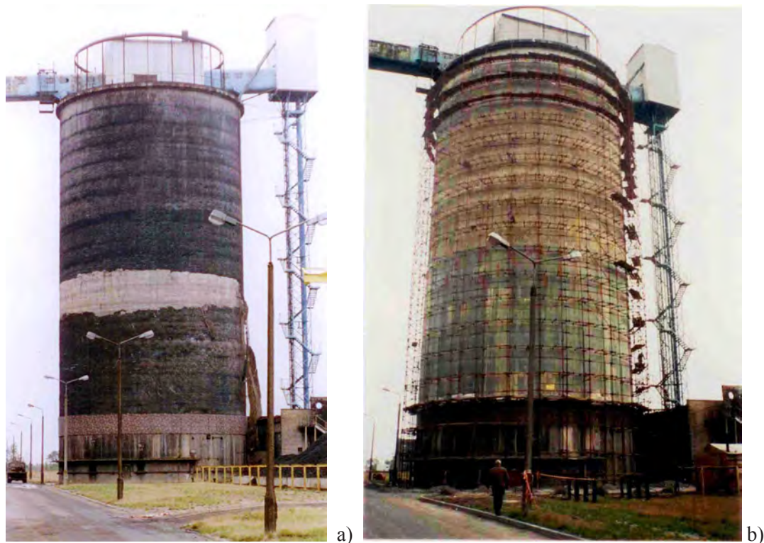
Rys. 2. Silos magazynowy A: a) tuż po awarii w 1995 r., b) podczas prac wzmacniających
