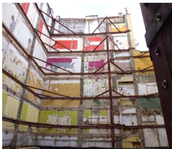
Rys. 2. Stalowa konstrukcja usztywniająca ścianę graniczną pomiędzy oficynami
