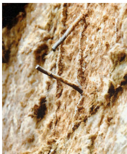
Rys. 3. Pęknięty pręt wieszaka. Pęknięcie nastąpiło w betonie warstwy fakturowej (fot. J. Szkwarek)
