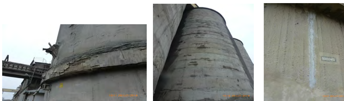
Rys. 7. Typowe uszkodzenia ścian silosów wynikające ze zbyt cienkiej otuliny prętów zbrojeniowych (na fotografii z prawej strony widoczna rysa doraźnie sklejoną przez użytkownika)
